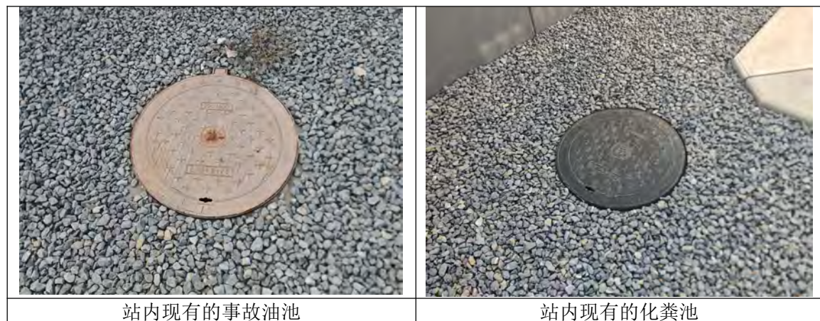
图 2 工程站内环保设施现状
